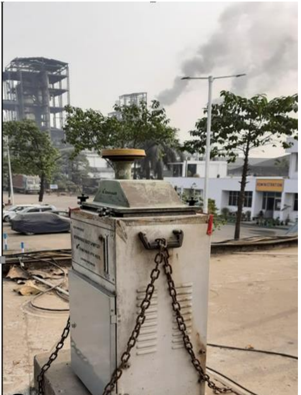
INDIA GLYCOL Ltd., GIDA 26°44'52.8"N 83°13'28.1"E
